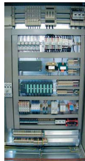
Paneles de distribución
